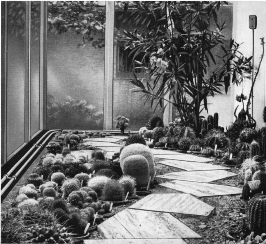
Die elektrische Beheizung mit Heizrohren fügt sich ohne weiteres in den Raum ein. Phot. W. Leiner
